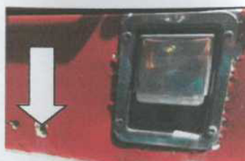
Obr. č. 13. . Sklopný nášlapný schod zadního pravého kola – totálně prorezivělý Pohled z venkovní strany
